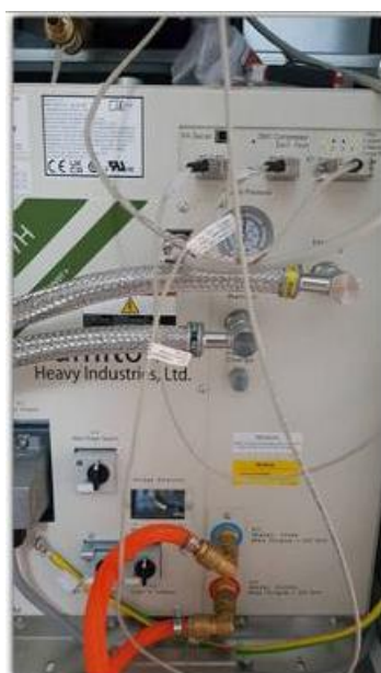
کمپرسور داخل کابینت cooling
